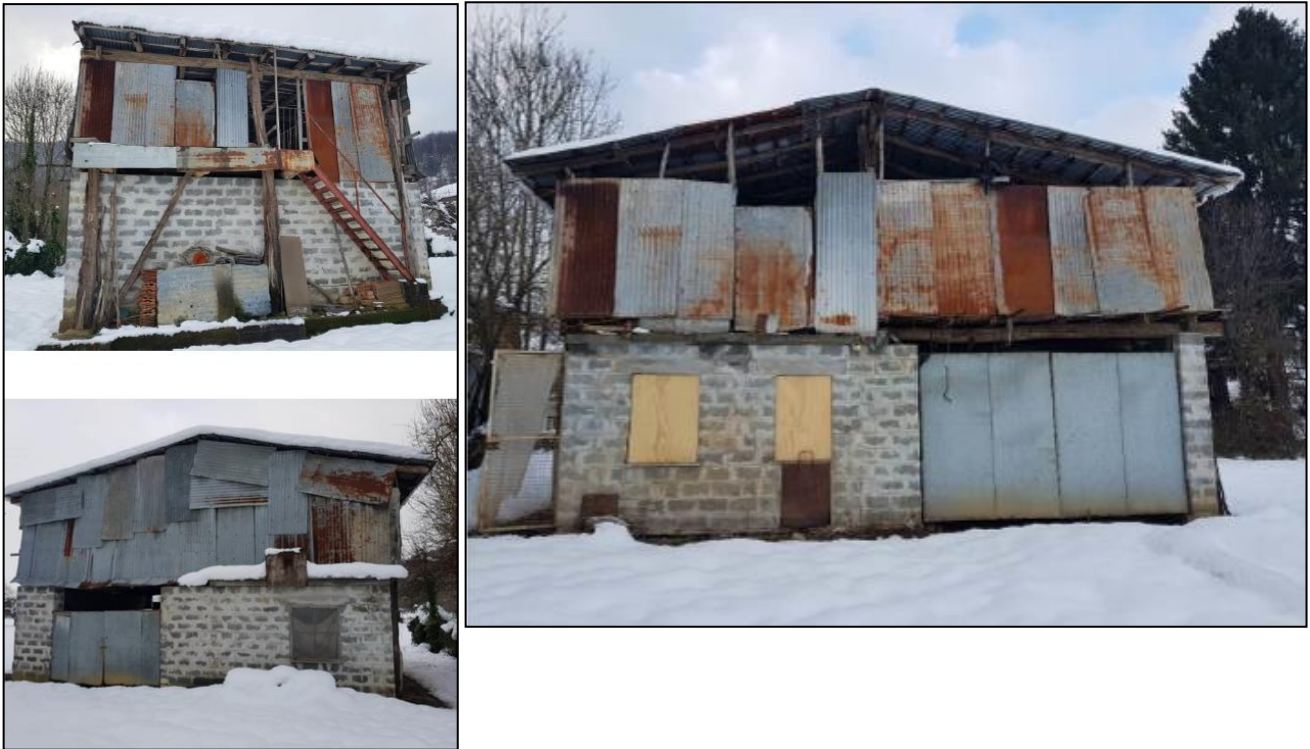
Vista dell'edificio oggetto di modifica (fronte est in alto a sx, fronte nord in basso a sx, fronte sud sopra)
